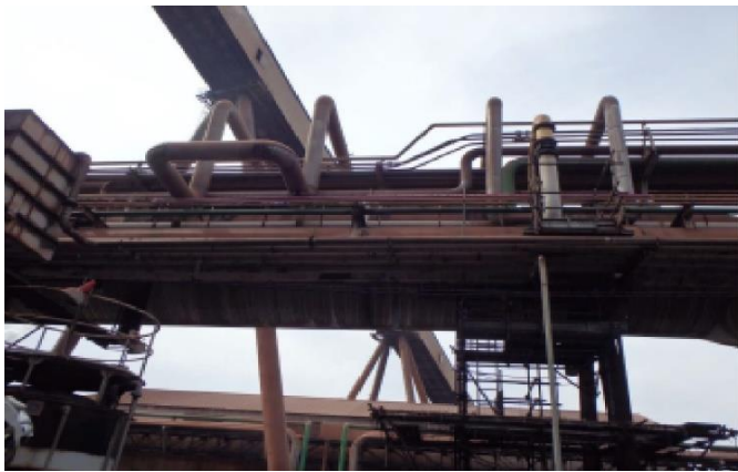
Hình 2 Phát hiện rò rỉ gas các ống dẫn gas ở những nơi cao khó tiếp cận
